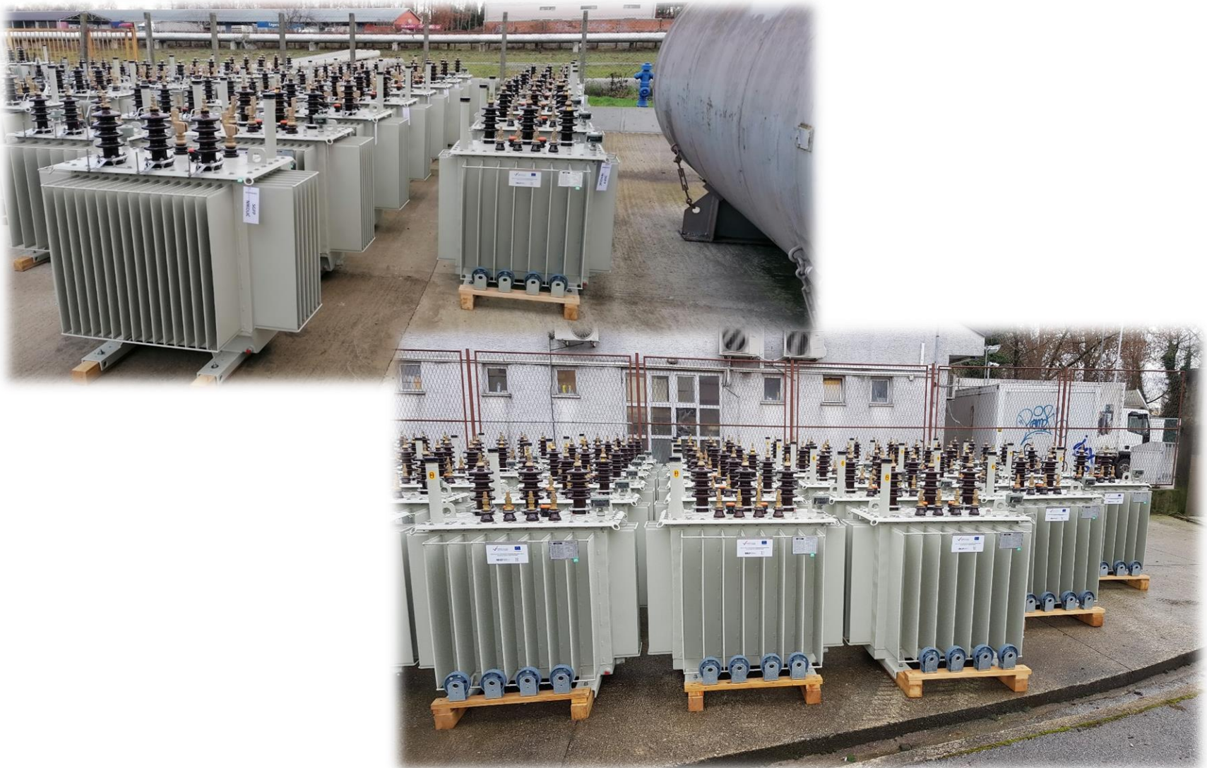
Slika 6.: Fotodokumentacija transformatora zaprimljenih na skladištu
