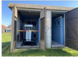
Trafostanica (fotografija sa otvorenim vratima trafo komore)
